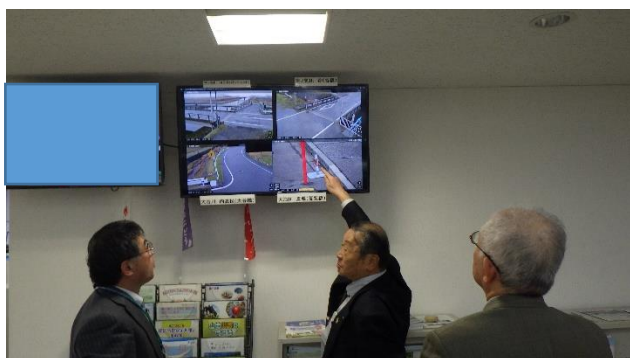
庁舎内監視カメラ（庁舎内）
