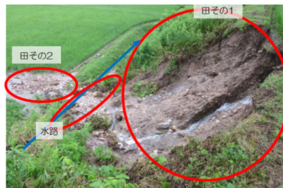
水田の崩壊したのり面（黒川地内）
