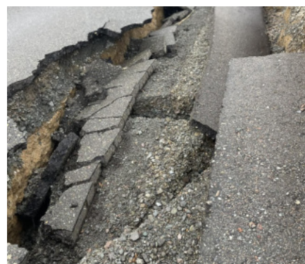
地震で地割れした道路
