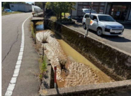
多田川の土砂堆積状況
