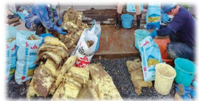
浸水したグラスウール
