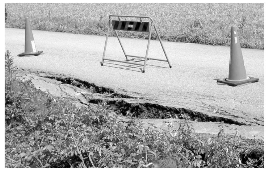
市道多田1号線の災害現場
