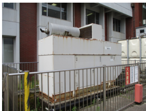
市庁舎の非常用自家発電設備
