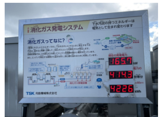
消化ガス発電システム
