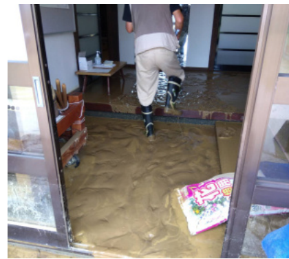
多田区集会所の被害
