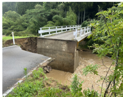
崩落した明乗寺橋（箕打地内）
