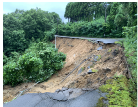
西山柿団地内の被災箇所
